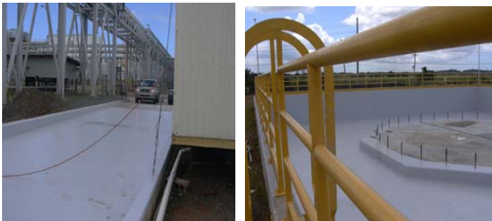
Bassin de rétention / Secondary Containment
